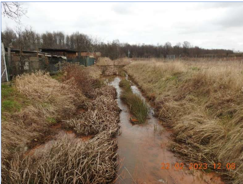
Zdjęcie 1 Zarośnięte i wypłycone koryto rzeki Ługowiny na odcinku poniżej ul. Trójkątnej (Leśnica) 44
