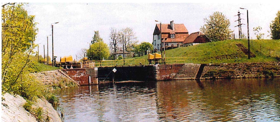
Głowa i awanport dolny śluzy małej oraz zabudowa przystopniowa od dolnej wody. Widok od dolnej wody przed ostatnim remontem.
