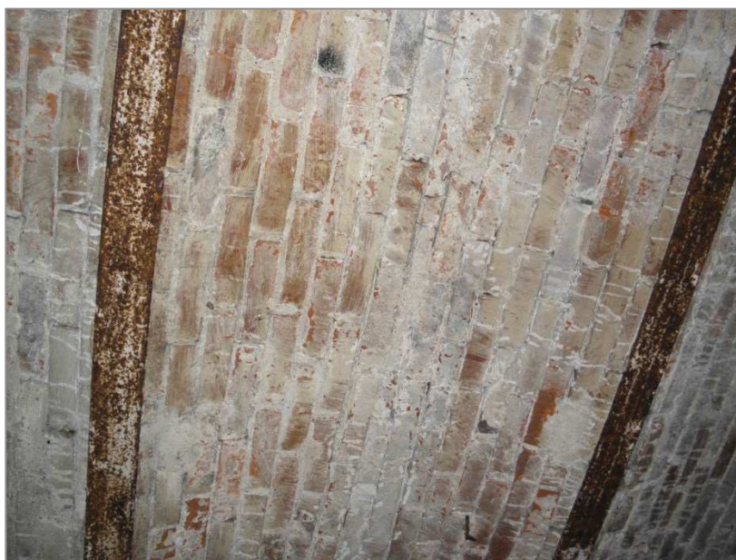
Fot. 36 Strop odcinkowy sutereny. Nieznaczna korozja stopek dolnych. Średni stan techniczny
