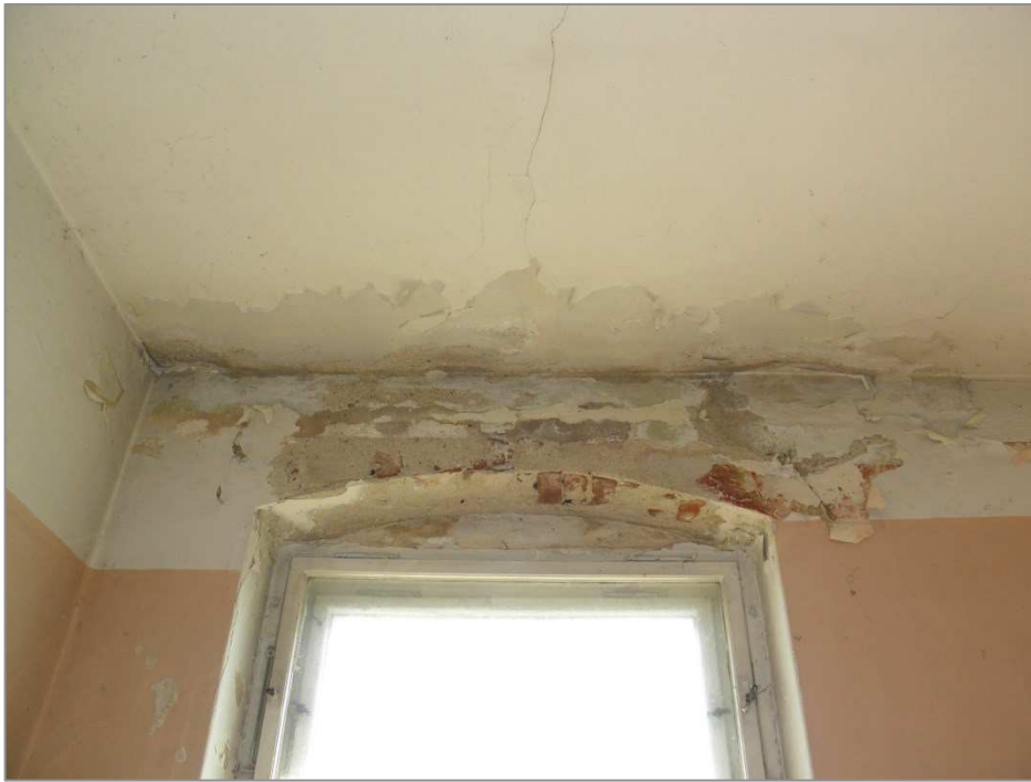
Fot. 31 Zacieki i odspojony tynk na połączeniu z płyta balkonową. Elewacja wschodnia
