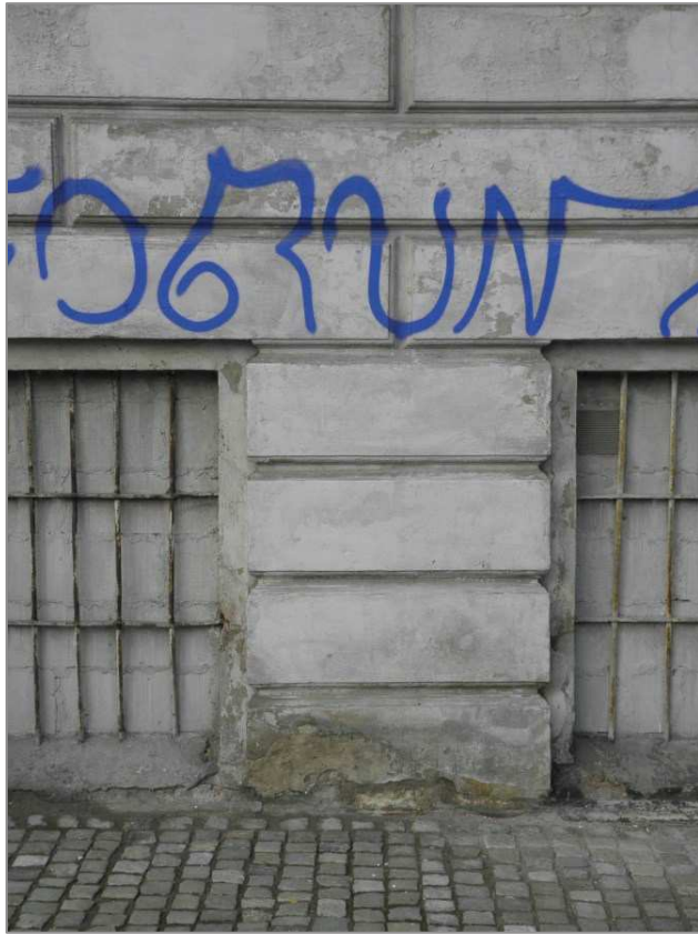
Fot. 27 Korozja, odpadanie tynku przyziemia
