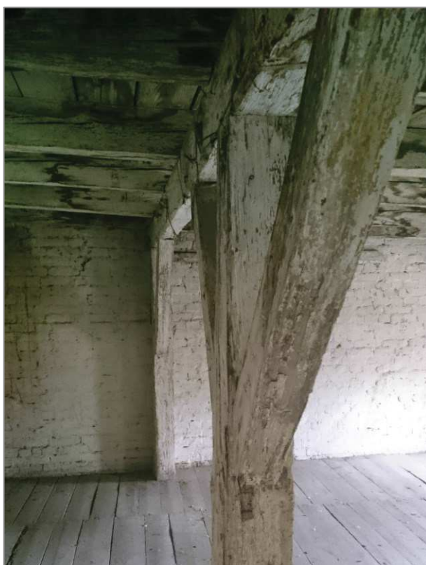
Fot. 85 Zniszczenia elementów więźby. Ślady zacieków. Grzyb domowy biały.
