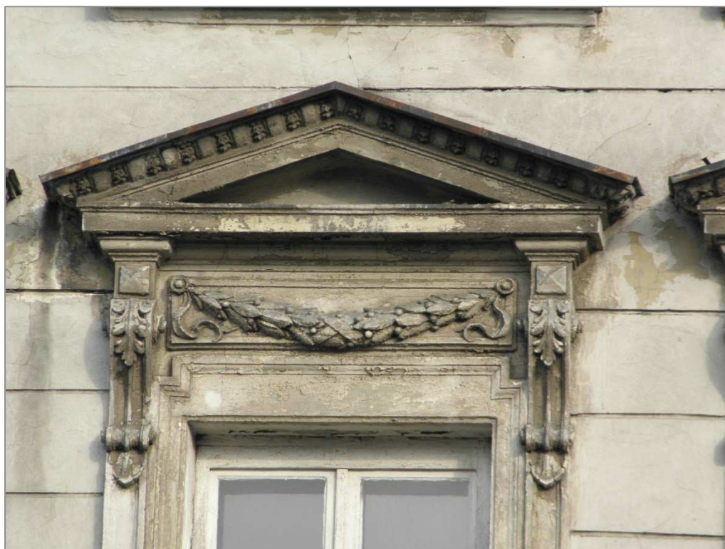
Fot. 16 Detal elewacji. Niewielkie zacieki między oknami. Łuszcząca się powłoka malarska. Niewielkie rysy strefy międzyokiennej.
