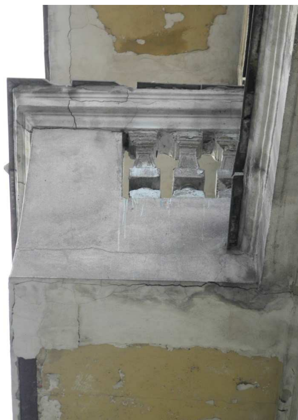
Fot. 13 Odspojenie się tynków. Zarysowania i spękania tynków i gzymsów. Zacieki spowodowane złym stanem technicznym obróbek blacharskich
