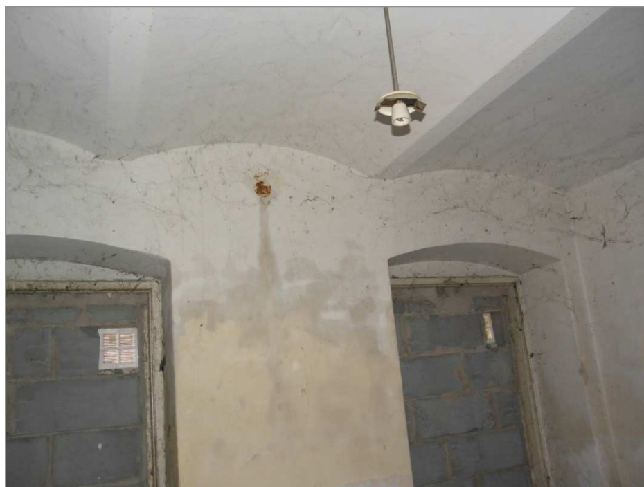
Fot. 26 Zawilgocenie ścian do wysokości ok. 2,0m
