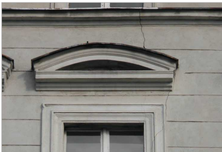
Fot. 7 Zarysowanie przestrzeni międzyokiennych na elewacji południowej
