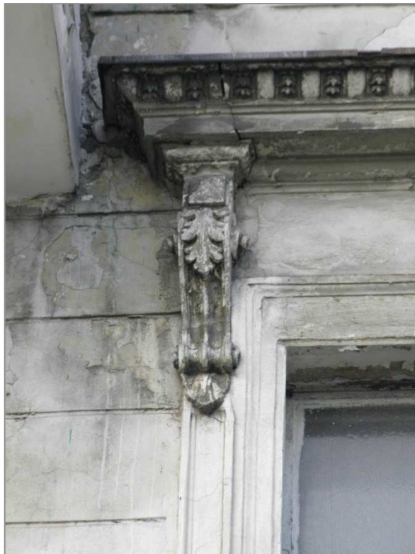
Fot. 56 Gzyms nad oknem przylegający do balkonu. Pęknięcia i korozja tynków spowodowana złym stanem technicznym balkonów.
