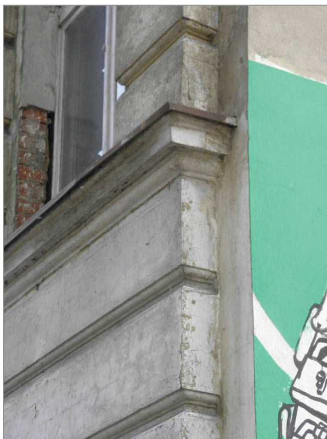
Fot. 70 Naroże oficyny. Odspojony tynk ościeży okiennych.
