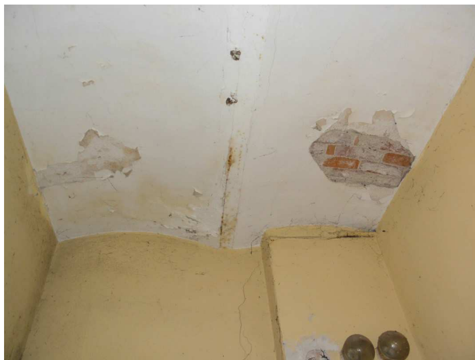
Fot. 42 Zawilgocenia stropu i odspojenia tynku stropu ceramicznego. Korozja stopki dolnej dwuteownika.
