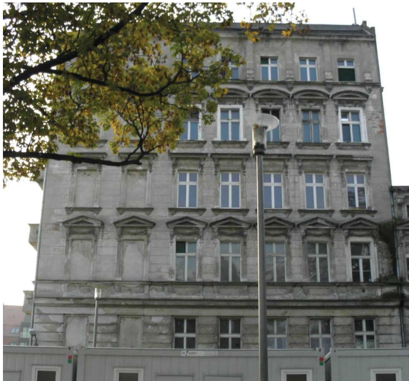
Fot. 21 Elewacja północna. Znaczne zacieki i korozja przy nieszczelnej rurze spustowej
