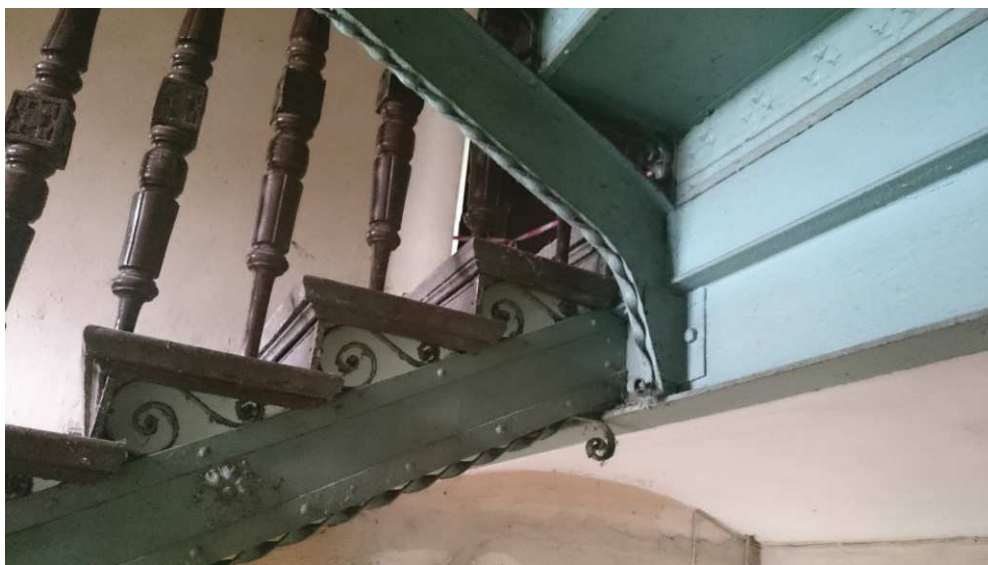
Fot. 78 Połączenie belki biegu schodowego z belką spocznika. Dobry stan techniczny połączenia.
