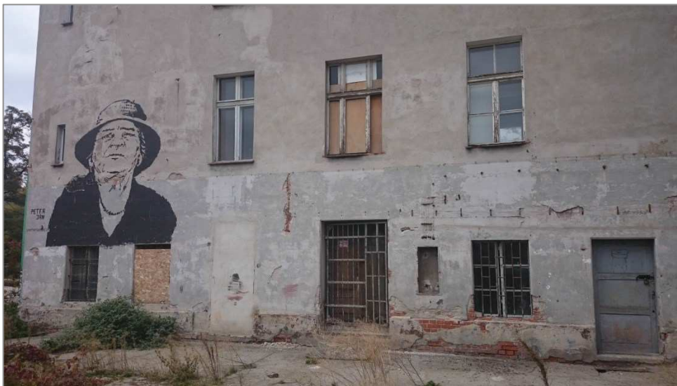
Fot. 64 Elewacja południowa. Korozja, odspojeni e tynków przyziemia. Zawilgocenia.
