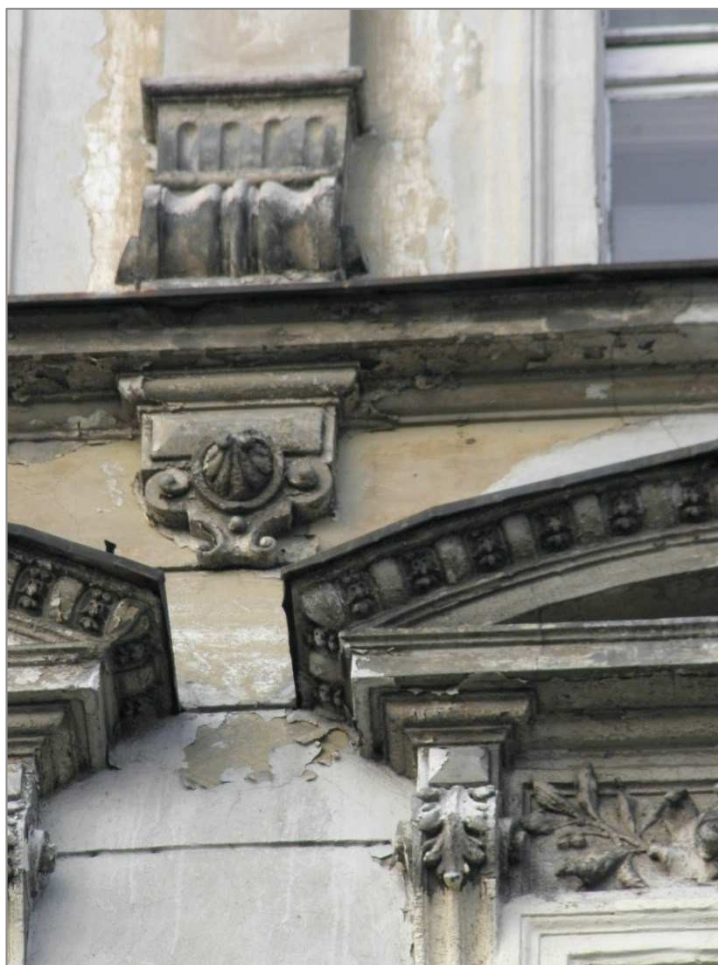
Fot. 11 Korozja tynków w strefie międzyokiennej. Zacieki. Łuszcząca się powłoka malarska
