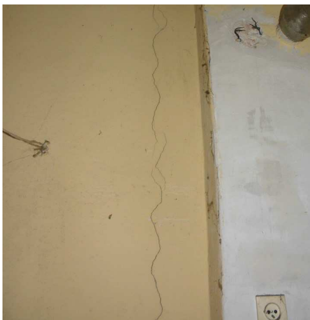
Fot. 30 Zarysowanie ściany zewnętrznej przy kominie. III piętro, ściana zachodnia
