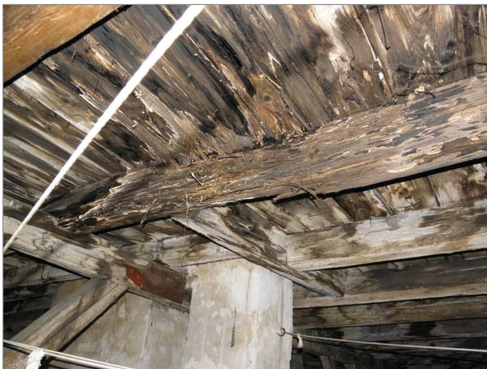
Fot. 58 Zniszczona krokiew i deskowanie spowodowane nieszczelnością pokrycia.
