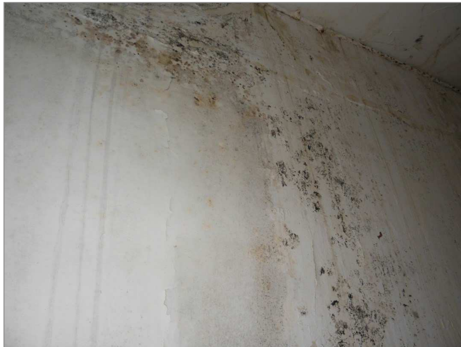
Fot. 33 Zawilgocenia ścian wysokiego parteru. Rozwój grzybów.
