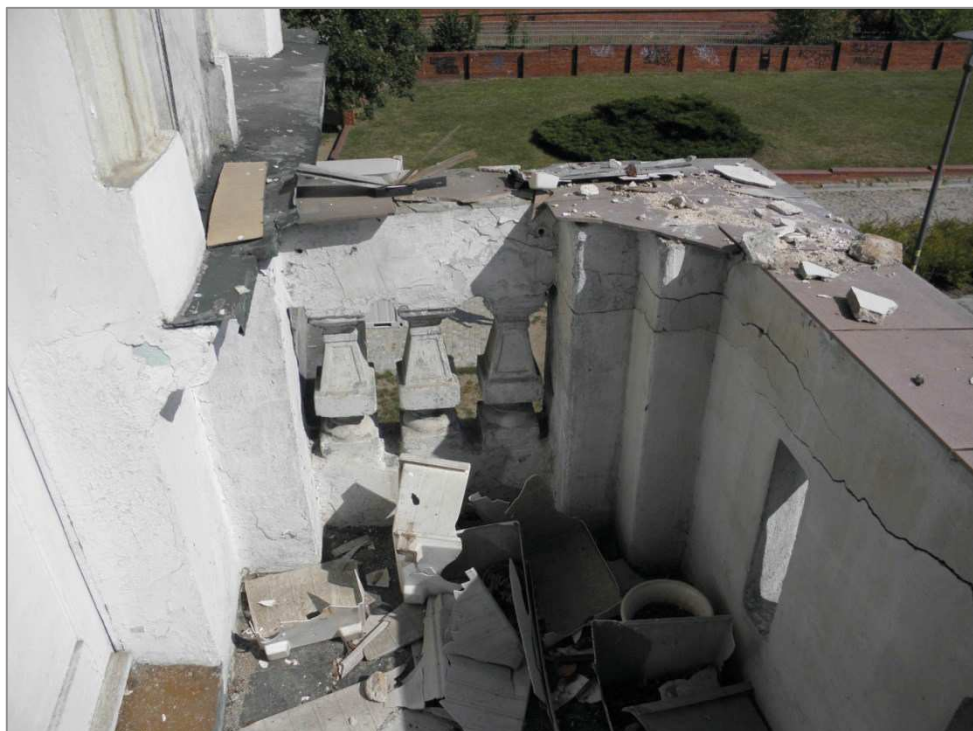
Fot. 53 Destrukcja murowanych balustrad. Brak obróbek blacharskich. Rysy i pęknięcia.
