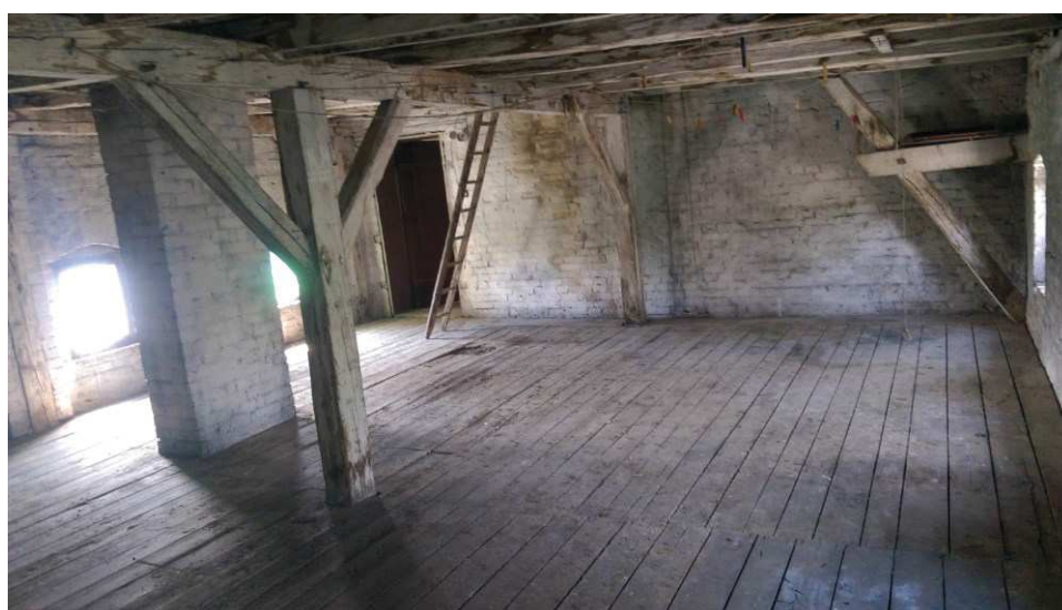
Fot. 83 Widok ogólny konstrukcji więźby. Zadawalający stan techniczny. Na większości elementów grzyb domowy biały i ślady zacieków.
