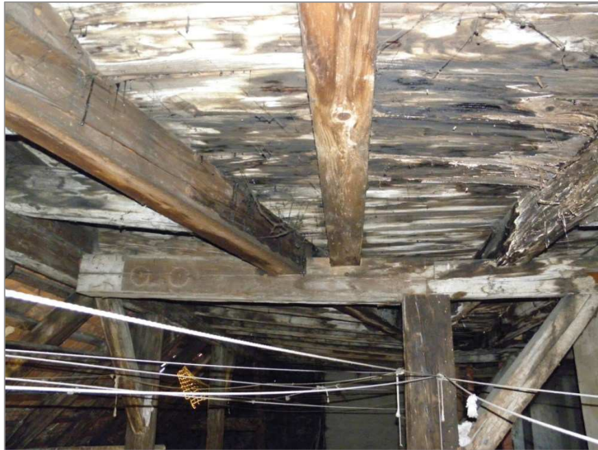
Fot. 62 Zniszczenia elementów więźby. Widoczne krokwie po wymianie. Po prawej stronie destrukcja krokwi.
