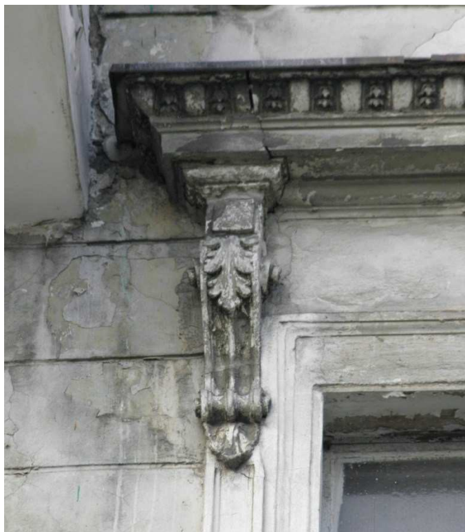
Fot. 12 Zacieki i korozja tynku przy styku z balkonem. Zarysowanie gzymsu nad konsolą. Łuszcząca się powłoka malarska
