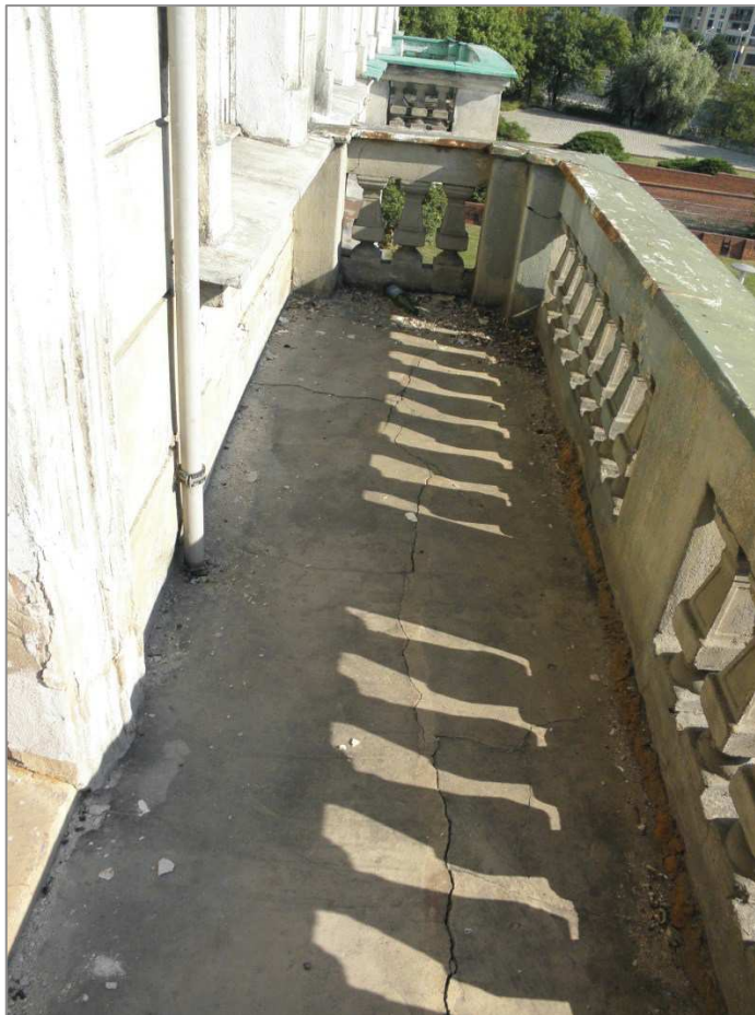
Fot. 54 Pęknięcia i zarysowania posadzki balkonów.
