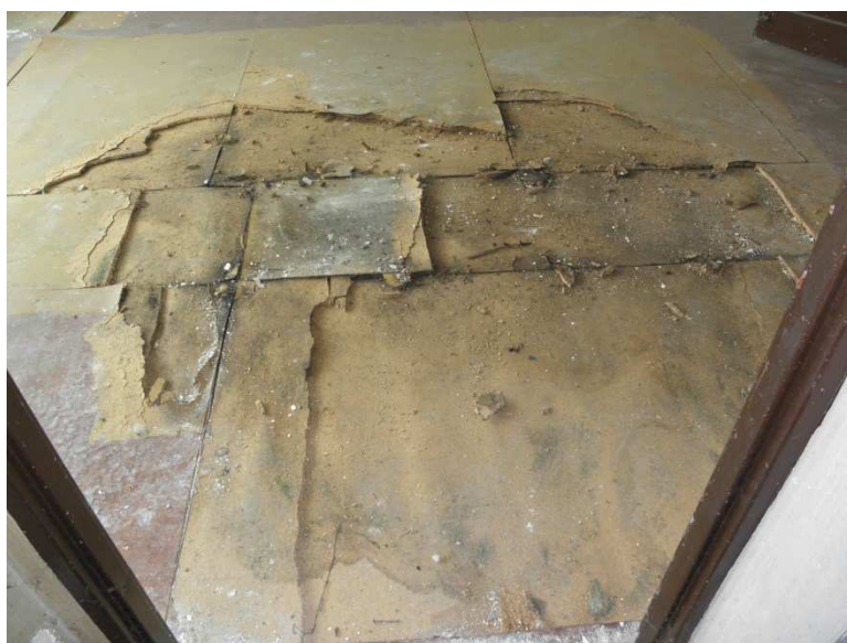
Fot. 40 Destrukcja podłogi IV piętra spowodowane nieszczelnością dachu
