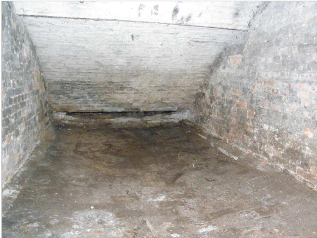
Fot. 48 Sklepienie biegu schodowego głównego wejścia. Osiadanie ceglanej podmurówki. Belki stalowe w średnim stanie technicznym. Zawilgocenie w strefie przyziemia. Osiadanie posadzki ceglanej
