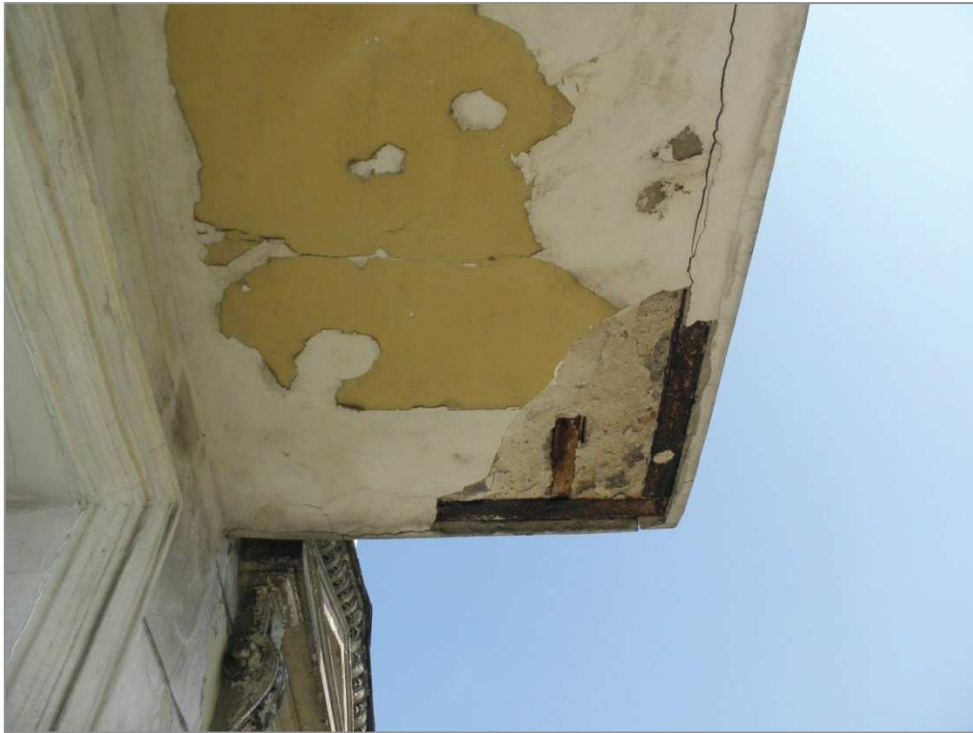
Fot. 52 Płyta balkonu. Odspojony tynk. Oslonięte stopki dolne dwuteowników. Spękania na krawędzi płyta-cegły stropu Kleina
