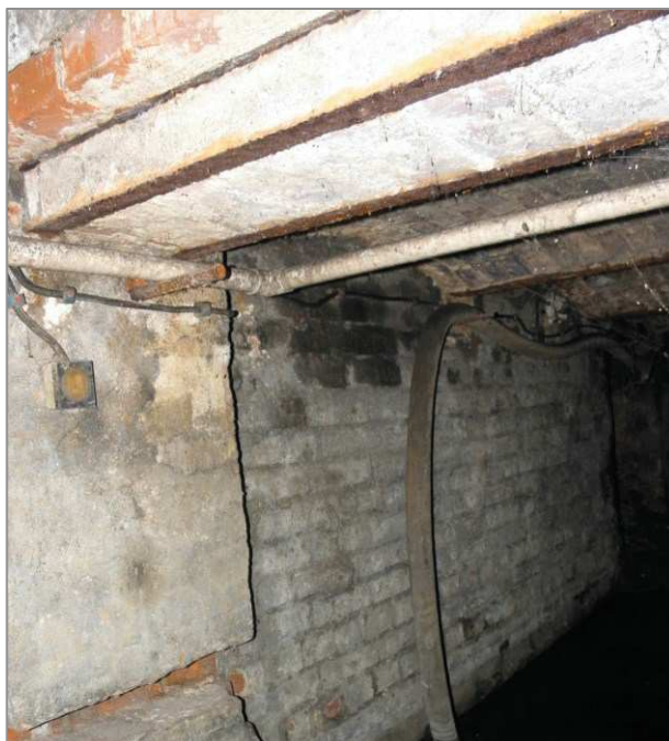
Fot. 75 Strop odcinkowy piwnicy. Znaczna korozja stopek dolnych. Zły stan techniczny.
