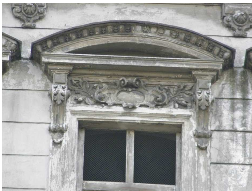
Fot. 22 Detal elewacji. Zacieki w strefie międzyokiennej
