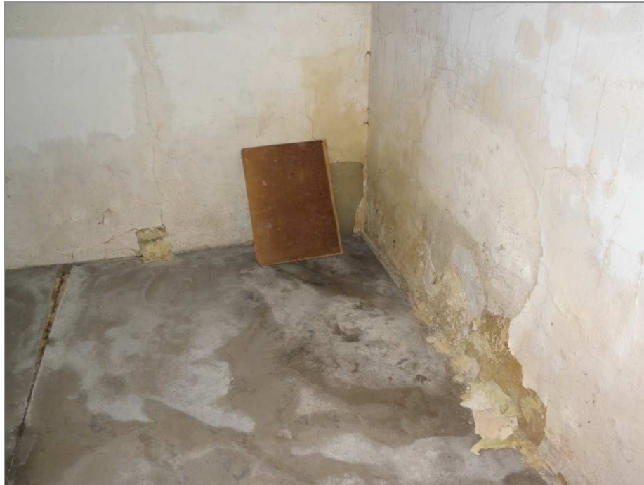
Fot. 25 Zawilgocenie ścian. Odspojenie tynku. Nie stwierdzono zarysowań
