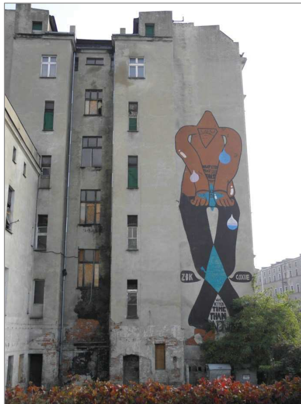
Fot. 18 Elewacja zachodnia; destrukcja tynku w strefie przyziemia i przy rurach spustowych
