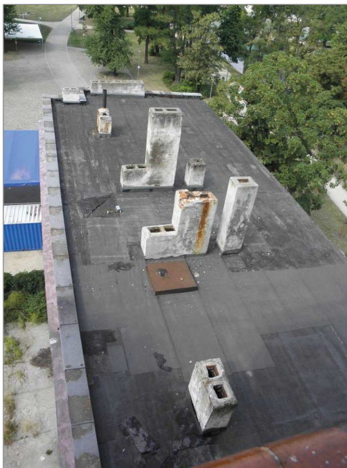
Fot. 86 Dach oficyny. Widoczne naprawy pokrycia. Zlasowana cegła kominów. Odspojone tynki.
