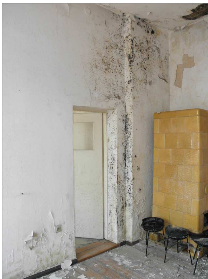
Fot. 34 Zawilgocenia i zacieki ścian parteru przy kominie.
