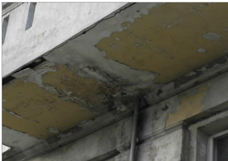
Fot. 55 Zacieki i zawilgocenia spowodowane złym stanem technicznym odwodnienia balkonów.
