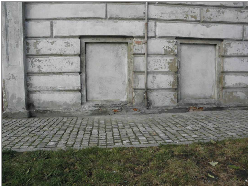
Fot. 10 Korozja tynków w okolicy przyziemia
