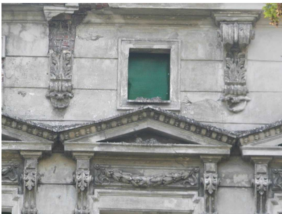
Fot. 72 Zniszczona konsola. Rysy w strefie międzyokiennej. Zacieki i korozja tynków
