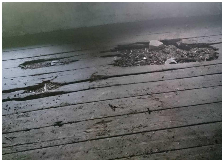
Fot. 77 Destrukcja podłogi poddasza. Korozja biologiczna.
