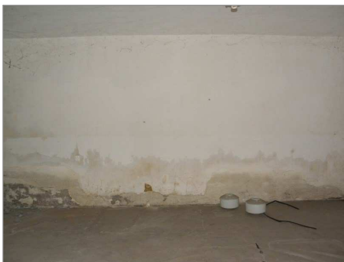
Fot. 24 Zawilgocenie ścian. Odspojenie tynku.
