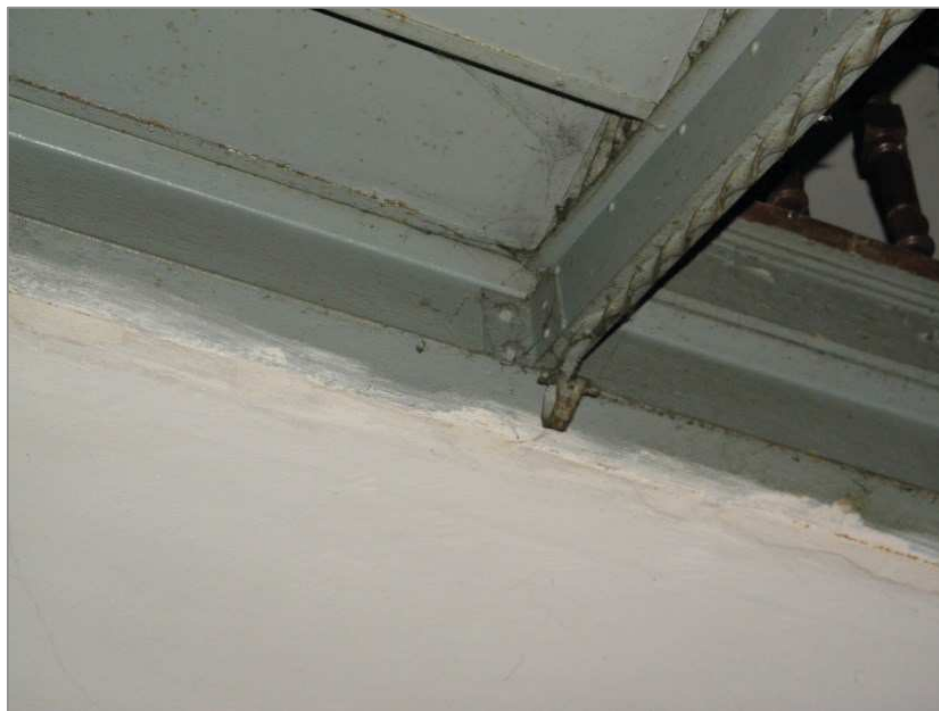
Fot. 43 Połączenie belki biegu schodowego z belką spocznika. Dobry stan techniczny połączenia.
