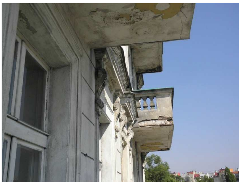
Fot. 51 Odspojenia tynku, spękania, zawilgocenia. Ogólnie zły stan techniczny
