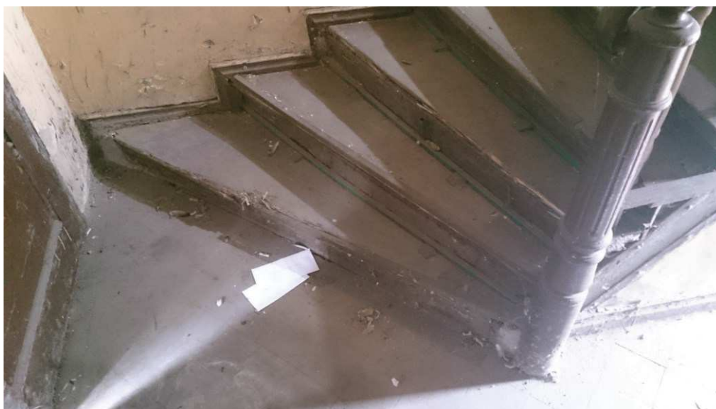
Fot. 79 Drewniane stopnie wyeksploatowane. Zły stan techniczny stopni
