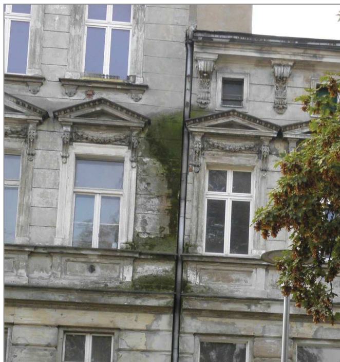
Fot. 23 Zacieki i korozja tynku przy rurze spustowej na połączeniu z budynkiem oficyny 7a
