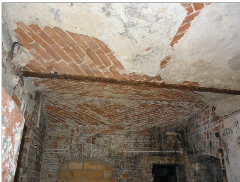
Fot. 35 Strop nad suterena od strony zachodniej budynku. Skorodowane stopki. Odspojony tynk.
