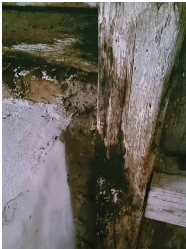
Fot. 84 Korozja krokwi i wymianu spowodowana nieuszczelnnością obróbek komina.
