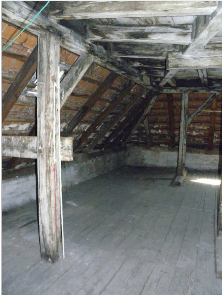
Fot. 60 Widok ogólny konstrukcji więźby. Fragment w średnim stanie technicznym. Na większości elementów grzyb domowy biały i ślady zacieków.
