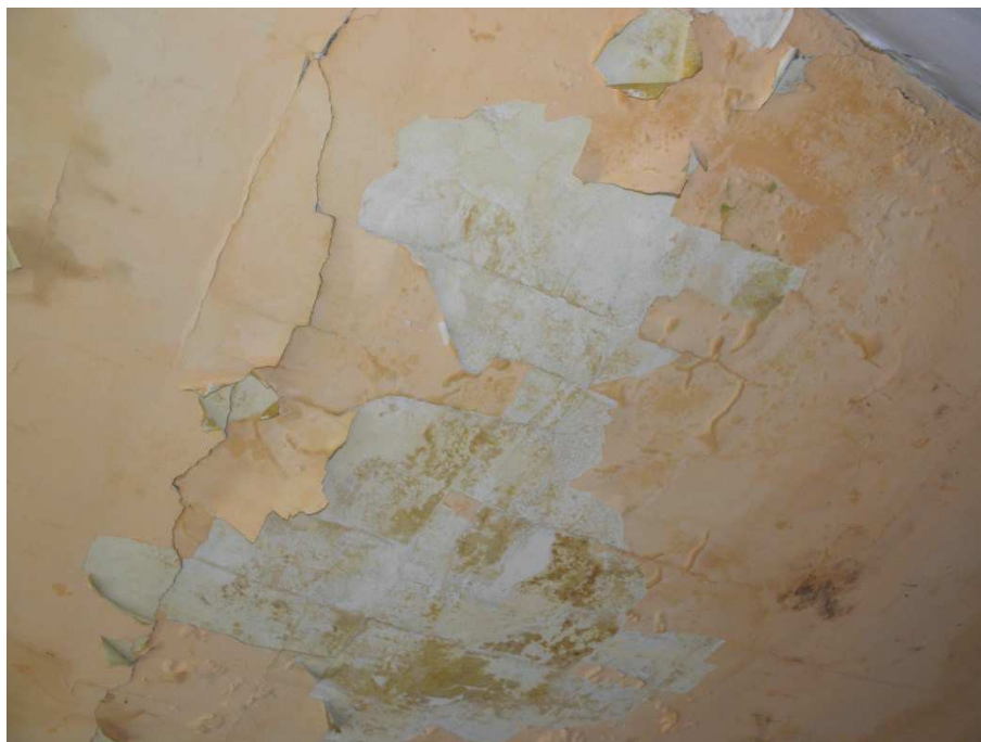
Fot. 41 Zawilgocenia sufitu III piętra spowodowane nieszczelnością pokrycia dachowego
