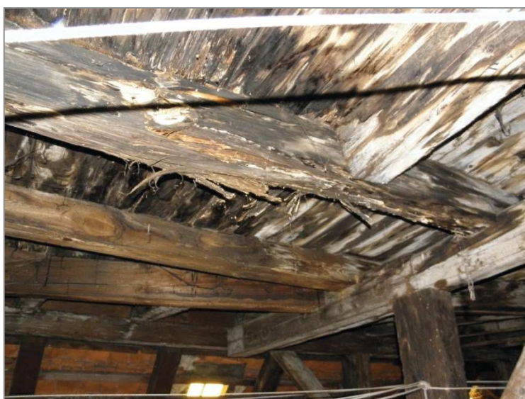
Fot. 57 Zniszczona krokiew. Grzyb domowy biały.
