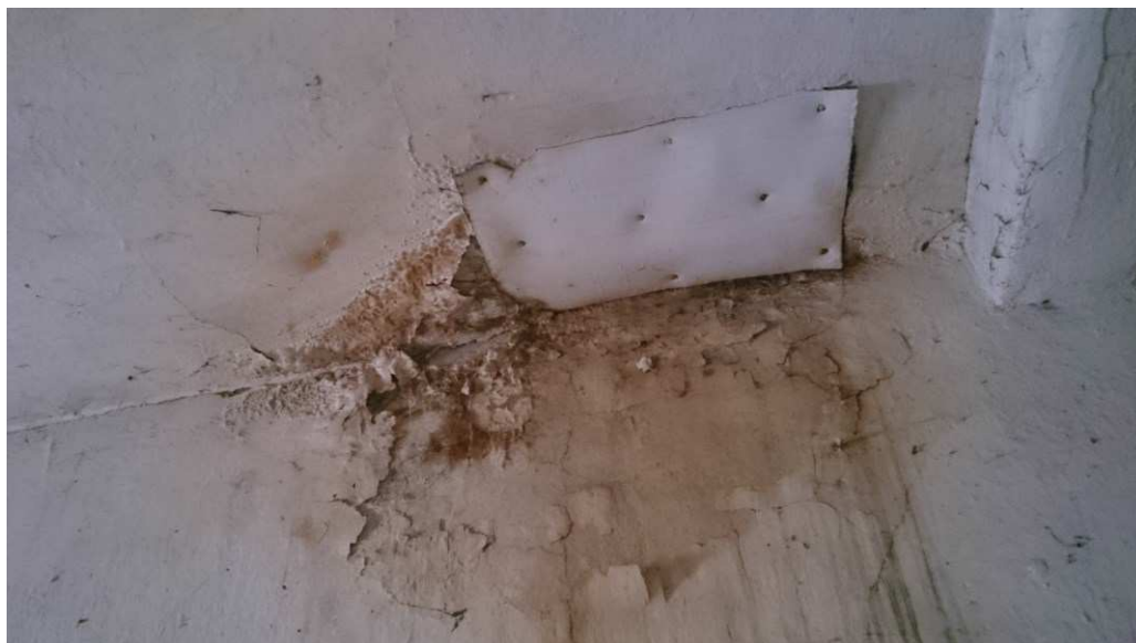
Fot. 76 Zawilgocony strop poddasza, zacieki spowodowane złym stanem technicznym pokrycia dachowego.
