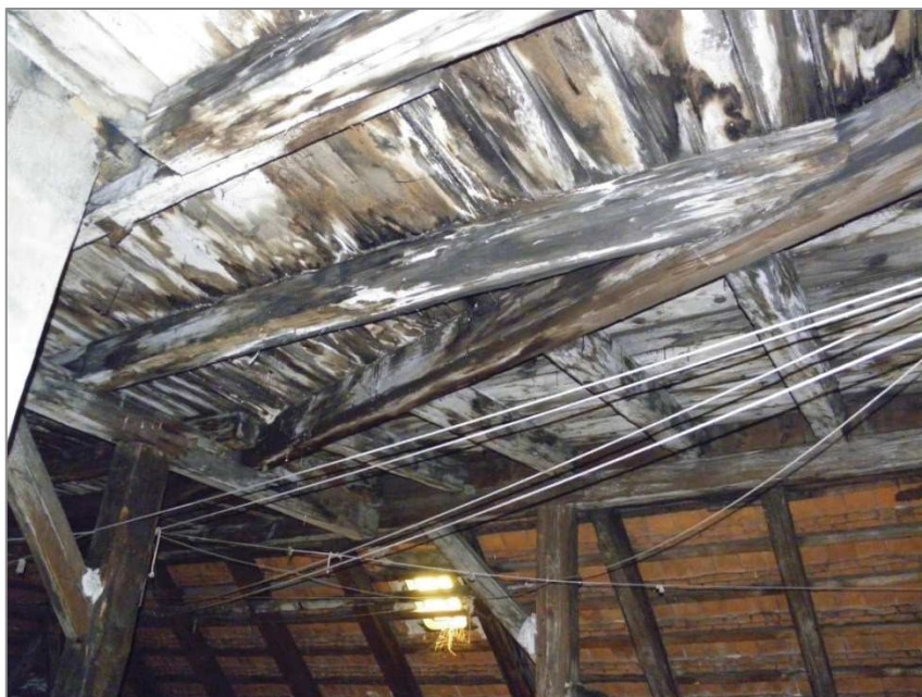
Fot. 61 Połączenie krokwi z płatwią. Liczne zacieki. Korozja deskowania.
