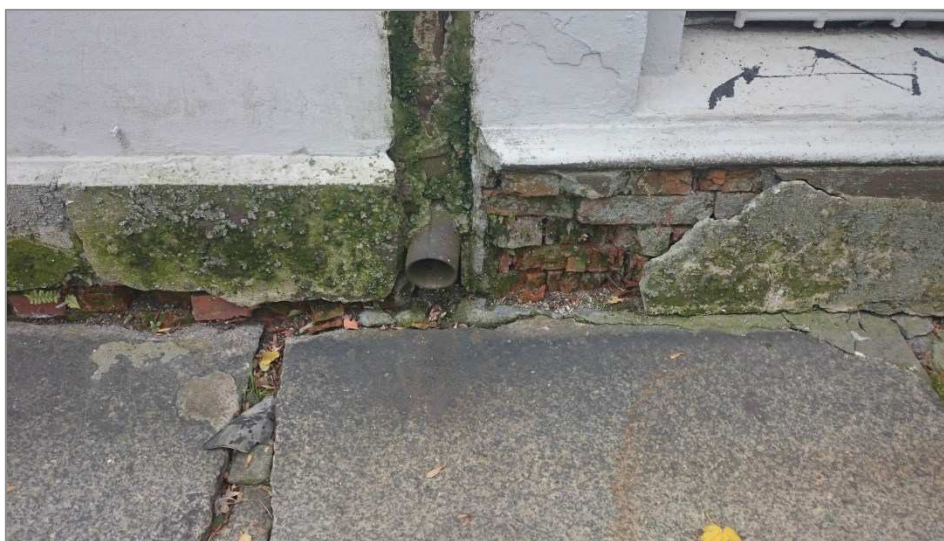
Fot. 68 Korozja, odspojenie tynków przyziemia.
