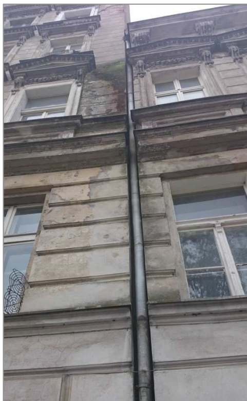
Fot. 71 Zacieki i korozja tynku na elewacji spowodowana nieszczelnością rury spustowej
