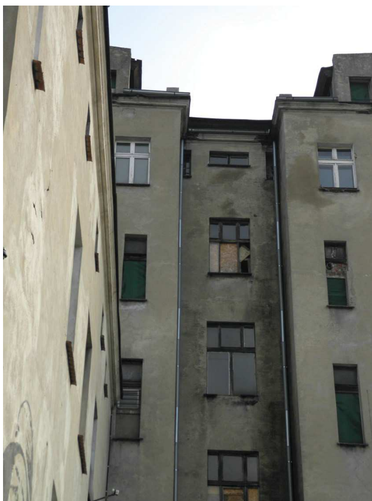
Fot. 20 Korozja i zacieki na elewacji w części wnęki środkowej
