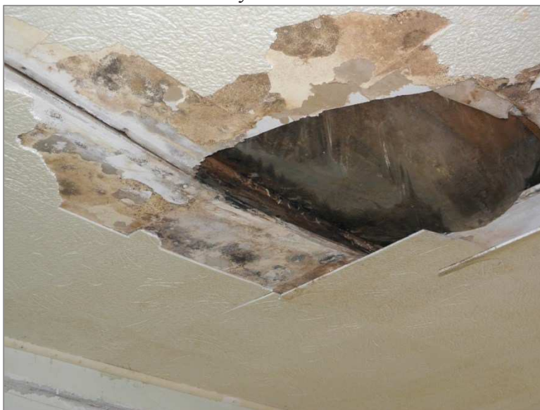
Fot. 39 Zawilgocony strop poddasza, destrukcja podbitki, spowodowane złym stanem technicznym pokrycia dachowego.
