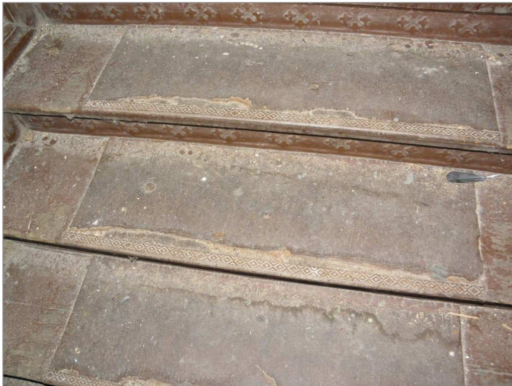
Fot. 44 Drewniane stopnie wyeksploatowane. Zły stan techniczny stopni
