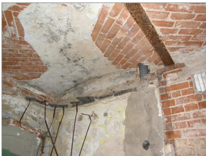
Fot. 74 Strop nad piwnicą. Miejscowo zlasowane powierzchniowo cegły. Znaczna korozja stopek dolnych dwuteowników
