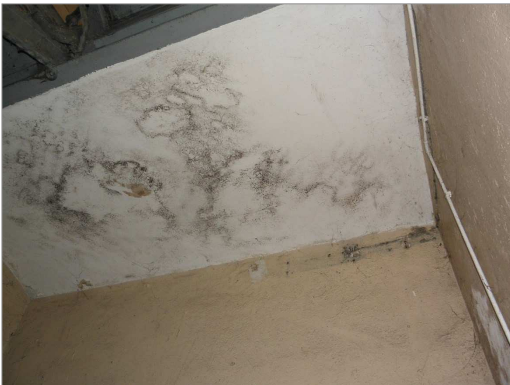
Fot. 49 Zawilgocenie sklepienia spocznika.
