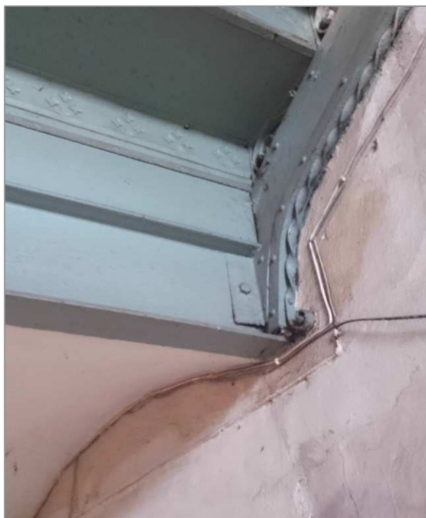
Fot. 82 Połączenie belki biegu z belką spocznika. Oparcie belki spocznika na murze. Dobry stan techniczny.
