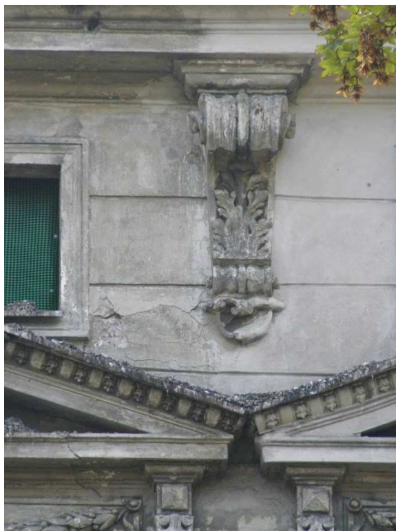
Fot. 69 Rysy i pęknięcia w strefach międzyokiennych. Uszkodzone konsole.
