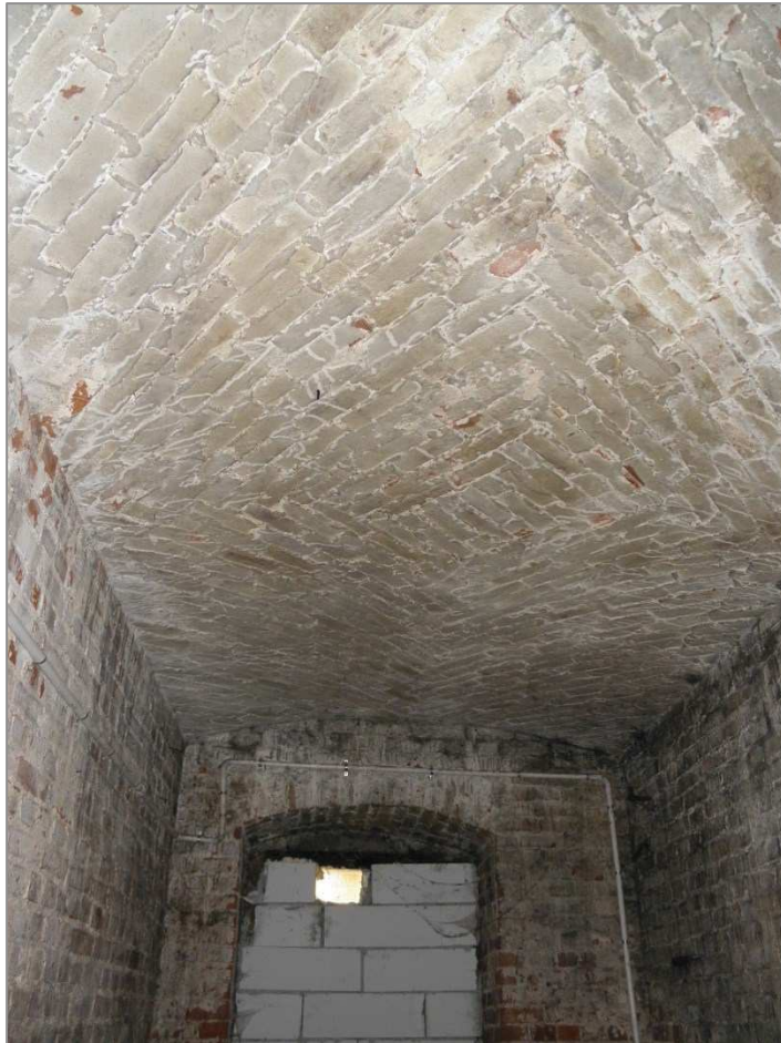
Fot. 37 Strop ceramiczny nad suteroną. Sklepienie oparte na ścianach podłużnych. Dobry stan techniczny
