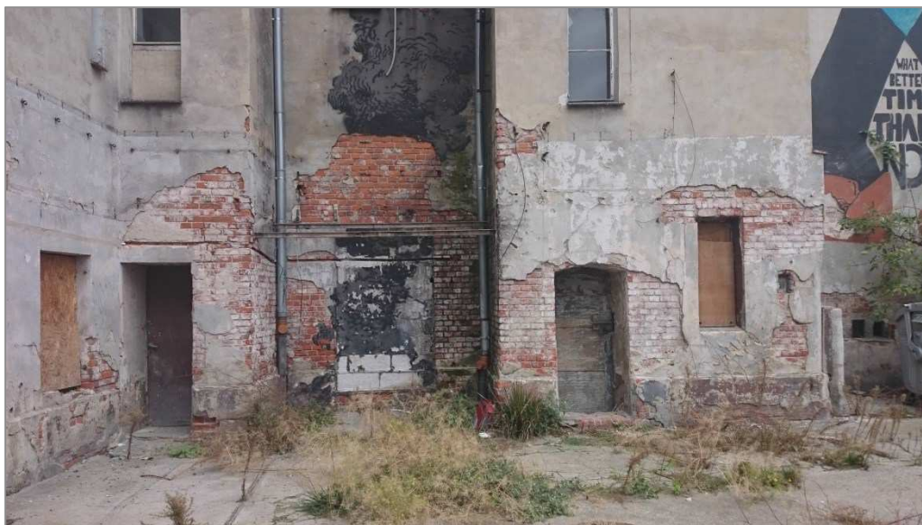
Fot. 19 Odspojony tynk, zawilgocone ściany do wysokości 5,5m
