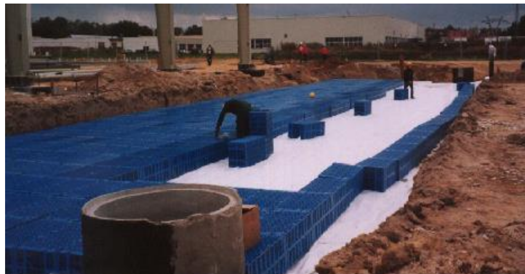
Skrzynki w funkcji retencyjno-rozsączającej pod powierzchnią parkingu, Pęcz k. Strzelina (fot. E. Burszta-Adamiak)
