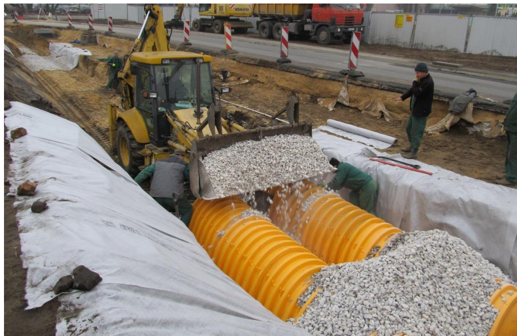
Komory drenażowe usytuowane w pasie drogowym, Warszawa (fot. K. Gudelis - Taraszkiewicz)
