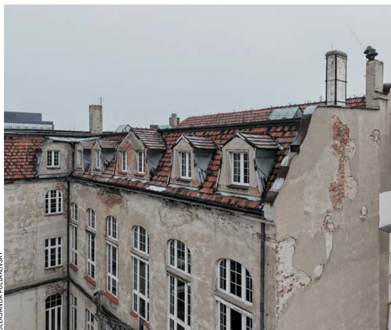
Pokrycia dachowe i fasada historycznego „Plastyka” czekają na remont
