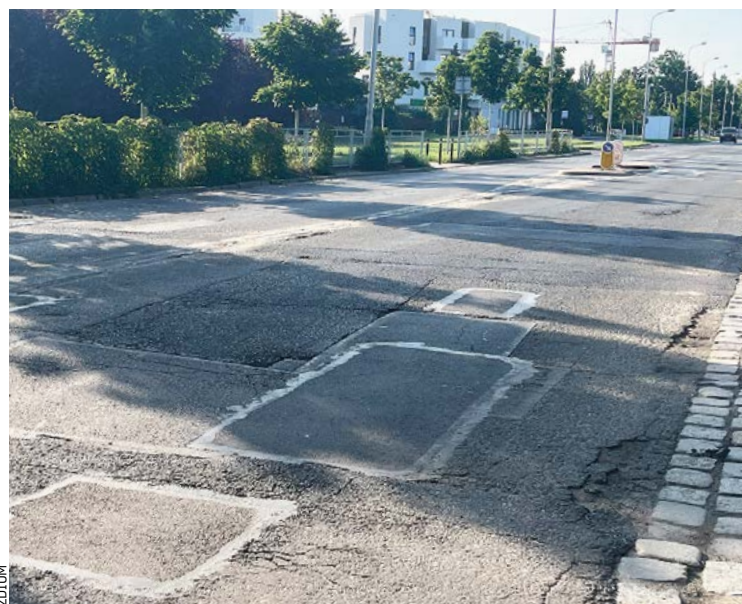
Zniszczony asfalt na ul. Bacciarellego na Bartoszowicach do wymiany
