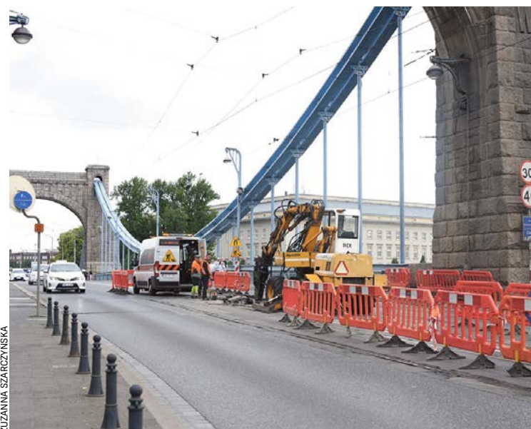
MPWiK usuwa awarię wodociągową na moście Grunwaldzkim, 13.07
