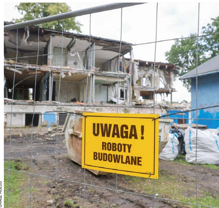
Częściowo wyburzony budynek klubowy przy stadionie na Zakrzowie
