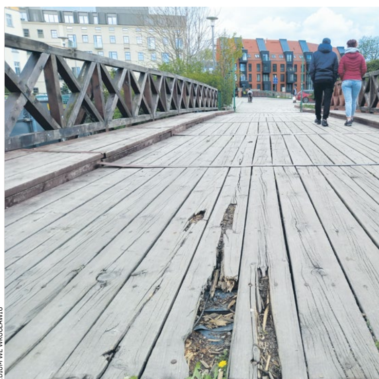
Przeprawa łącząca Wyspę Słodową z Bielarską jest w złym stanie
