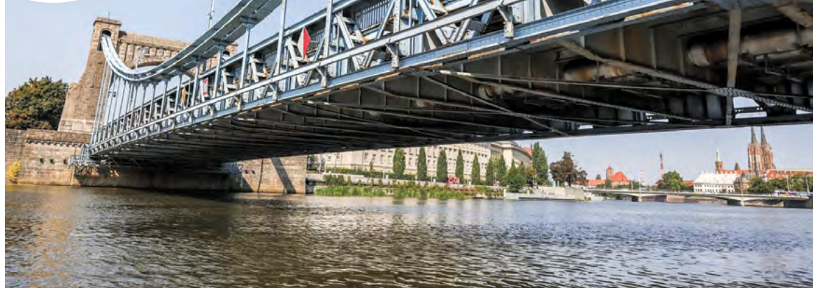
Dopiero z bliska i z poziomu rzeki pod Mostem Grunwaldzkim widać wyraźnie przedziewałe elementy
