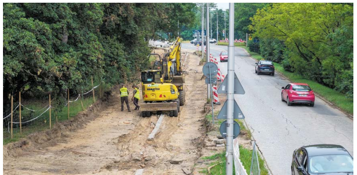
Ekipa budowlana wykonuje korytowanie pod nowe torowisko po północnej stronie ulicy Mickiewicza
