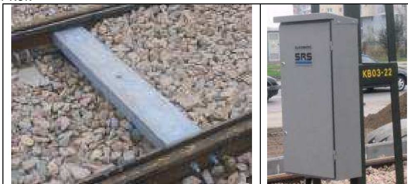
Rysunek 16. Przykład smarownicy torowej SRS oraz szafy z aparaturą sterowniczą smarownicy ( http://www.transportszynowy.pl )
