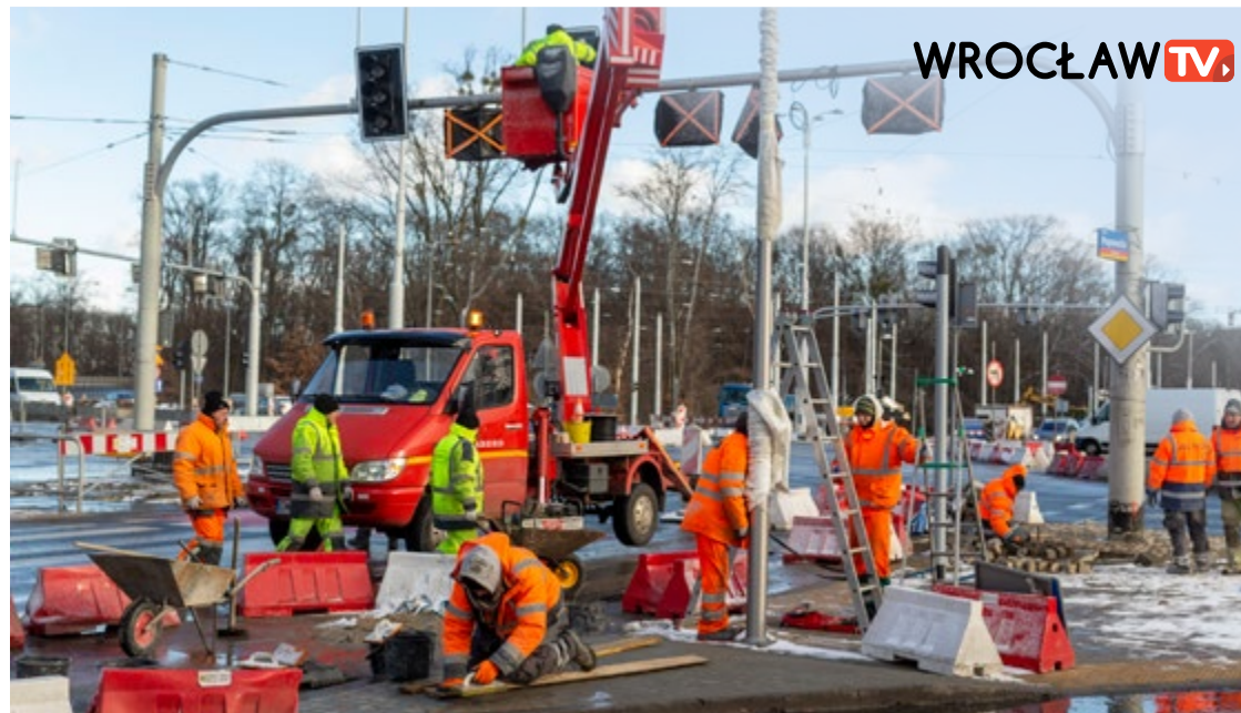
Ostatnie prace wykończeniowe na skrzyżowaniu ulicy Popowickiej z ulicą Milenijną we Wrocławiu
