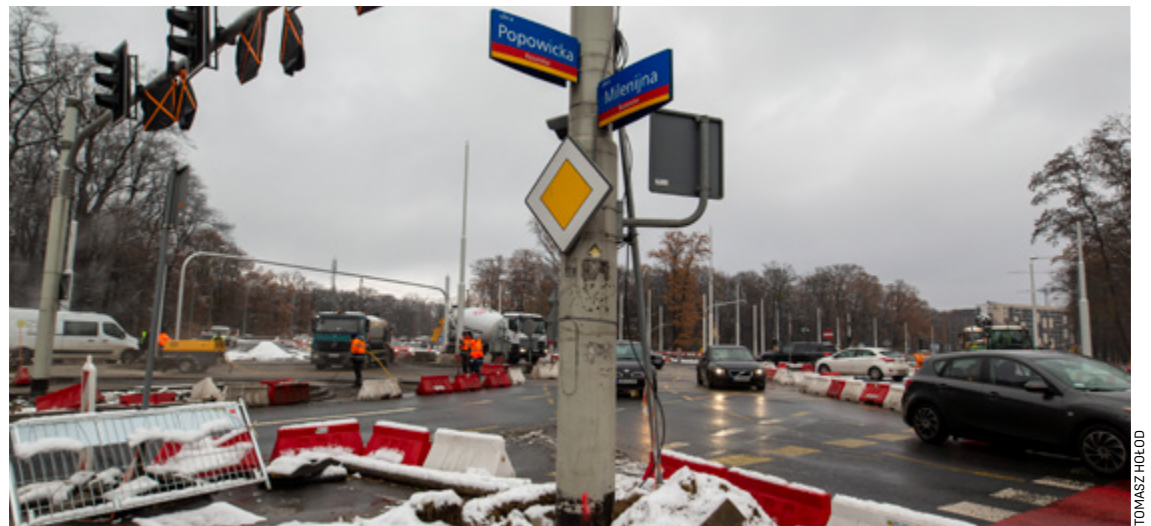
Robotnicy pracują nawet kiedy pada śnieg. Od 9 do 12 grudnia zaplanowano prace przy rurociągu
