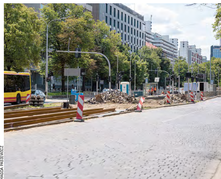
Ponadstuletnia droga jest wysłużona, kostka uległa odkształceniom
