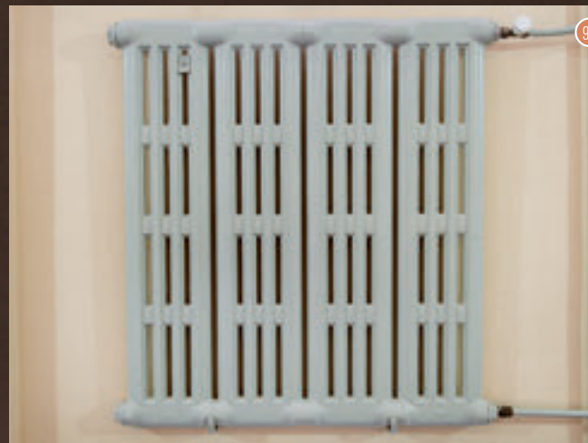
93 Dom nr 31, proj. Hans Scharoun, oryginalny kaloryfer w korytarzu lewego skrzydła budynku, 2014, fot. Natalia i Ernest Dec
