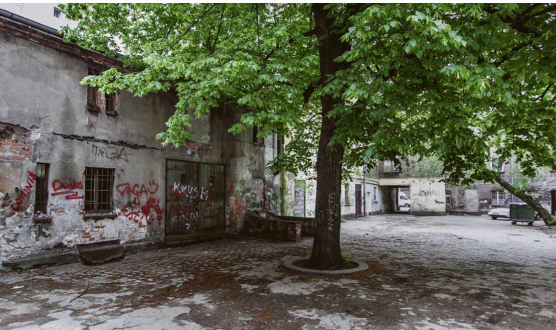
Jeszcze kilka lat temu stan budynków kwalifikował je do rozbiórki, a na jednej z elewacji widniał czerwony napis: Grozi zawaleniem. Fot. Maciej Kulczyński
