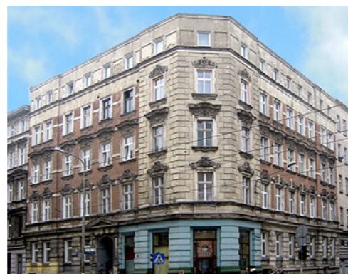
Kamienica przy ul. Bolesława Chrobrego przed i po remoncie: w pierwszym naborze zrealizowaliśmy 23 projekty, w drugim 13. Fot. archiwum Atena Sp. z o.o.
